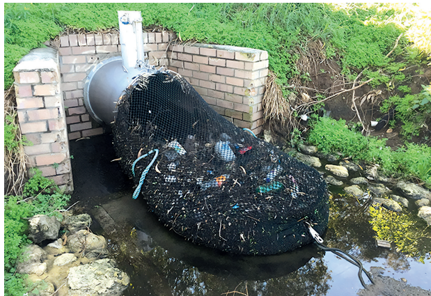
Figura 3: Red para el alcantarillado llena de contaminación del río
